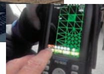
←同ブルドーザー車内のICT機器
